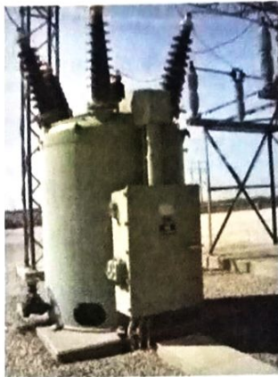
รูปที่ 8.14 บัลก์ออยล์เซอร์กิตเบรกเกอร์ชนิดถังเดี่ยวติดตั้งนอกอาคาร
