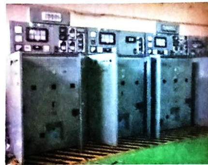
รูปที่ 8.13 มินิมัมออยล์เซอร์กิตเบรกเกอร์
